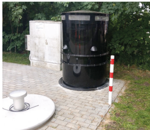
Filtro para la eliminación de olores del aire de escape de un pozo de alcantarillado (Fuente: HeGo Biotec International GmbH)
