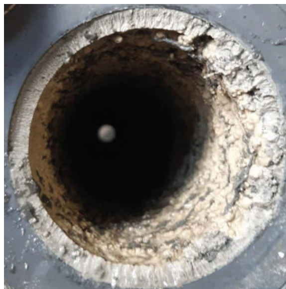
Querschnitt einer Rohrleitung mit Inkrustationen
