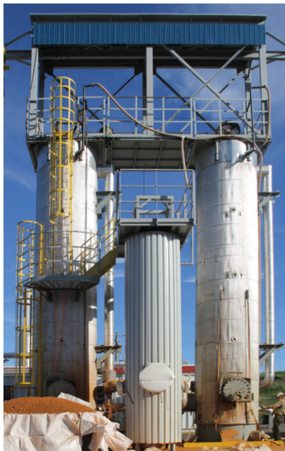
Deponiegasanlage in Quebec, Kanada (Quelle: HeGo biotec GmbH)
