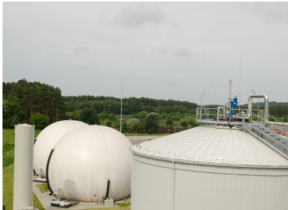
Biogasanlage mit Gärreaktor und externen Gasspeichern (Quelle: sauletas|stock.adobe.com)
