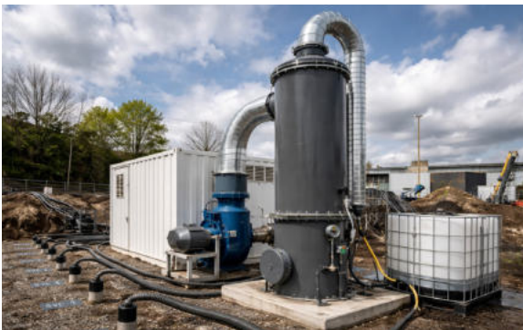
Sanierungsanlage zur Bodenluftabsaugung mit nachgeschalteter Aktivkohlefiltration zur Behandlung VOC-belasteter Abluft (Quelle: KI-generiert | OpenAI DALL-E, 2026)
