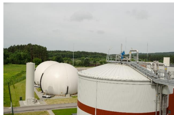
Abbildung 4: Biogasanlage mit Faultrum und externen Gasspeichern
